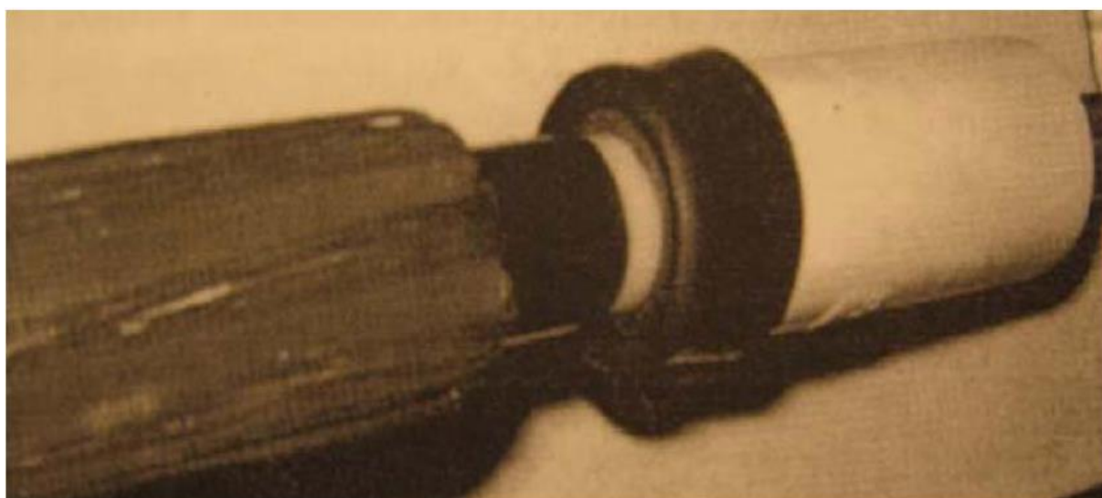
Slika 11.13. Prikaz loše povezanih kabela, gdje je uklonjeno previše poluvodljivog sloja, pa dolazi do povećanja električnog polja na tom mjestu
