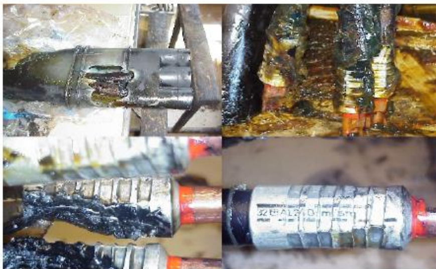
Slika 11.1. Različiti kvarovi na izolaciji kabela u distributivnoj mreži
