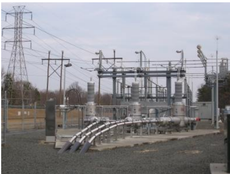
8.3. HTS kabeli u pogonu
