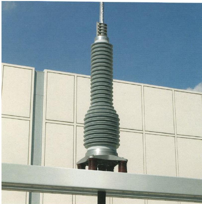
Vanjski samostojeći suhi završeci OHVT za 145 kV
